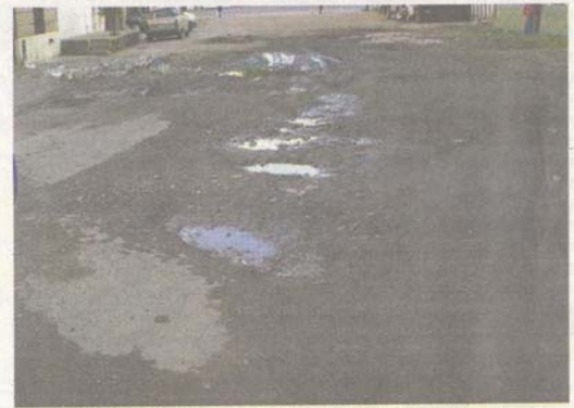
PAVIMENTO. VECINOS DE CASTILLO ASEGURAN QUE VIENEN EXIGIÉNDOLO HACE AÑOS.
